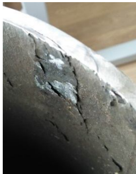
Рис. 1 – Общий вид дефекта
